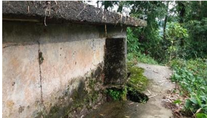
Fugas en tanque de distribución
