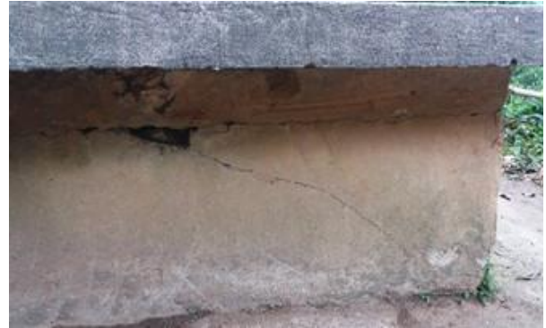
Grietas en tanque de distribución
