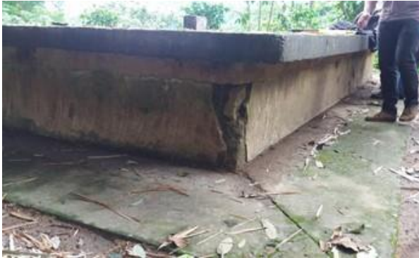
Daños en la estructura del tanque de distribución
