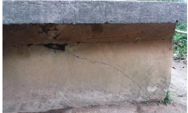
Grietas en tanque de distribución
