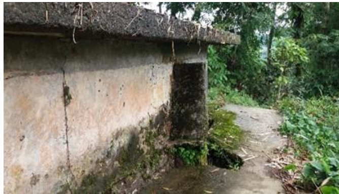
Fugas en tanque de distribución
