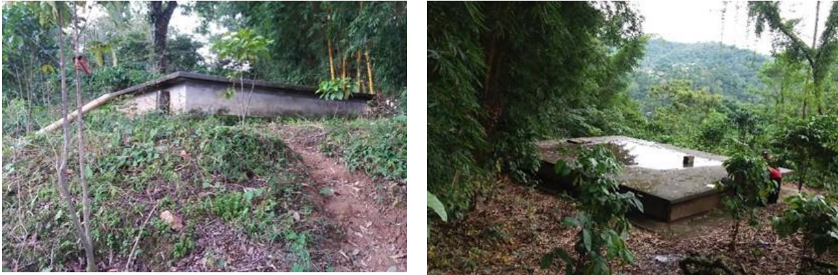
Ilustración 3. Tanque de distribución El Zapote. Nuevo Progreso, San Marcos
